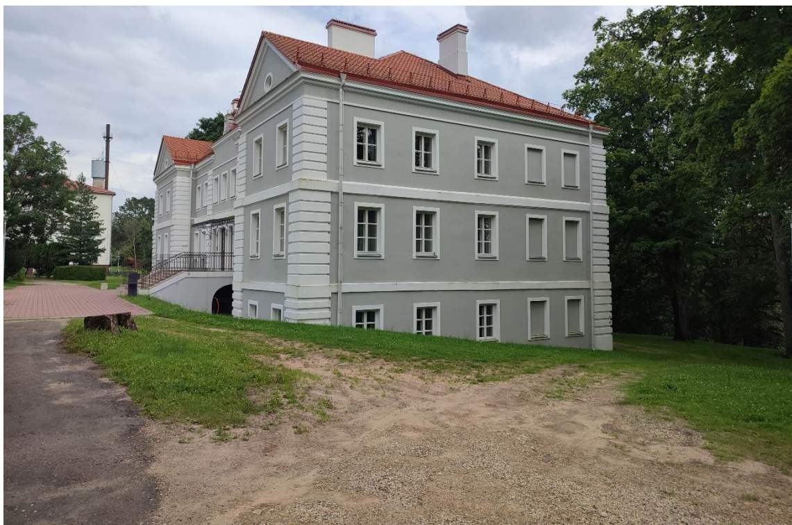
Vaizdas nuo V pusės. Asfalto danga- susidėvėjusi, dėl neįrengtos atsparios dangos aplinkui pastatą vyksta šlaito erozijos procesas
