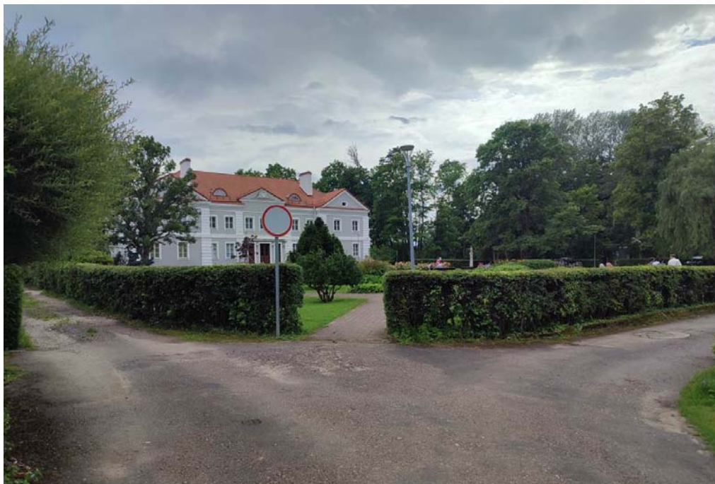
Vaizdas nuo ŠR pusės. Aukštos gyvatvorės uždari erdvę, paversdami ją kamerine. Asfalto danga- susidėvėjusi
